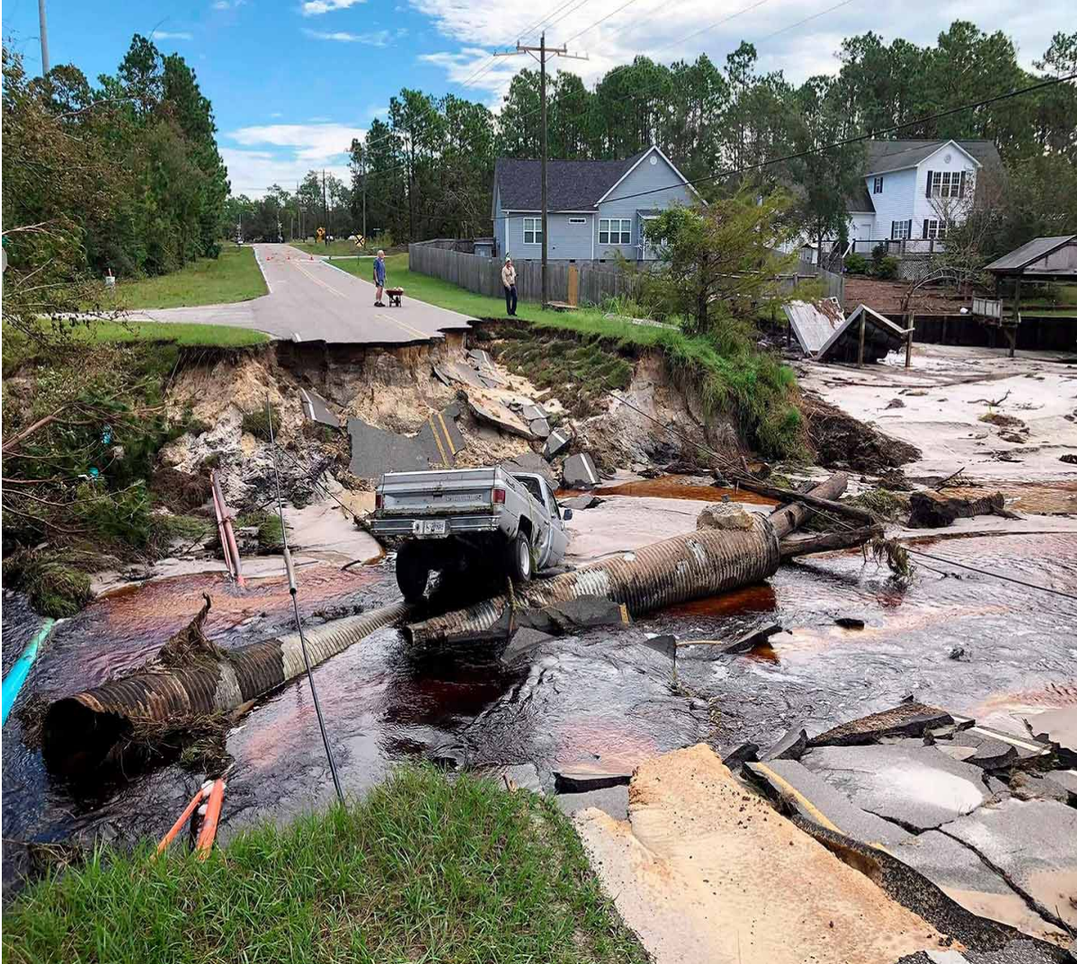
Une route détruite par les inondations provoquées par la tempête tropicale Florence à Charlotte, aux États-Unis, en 2018 — Photo Nate Orlowski/Zuma/Réa.
